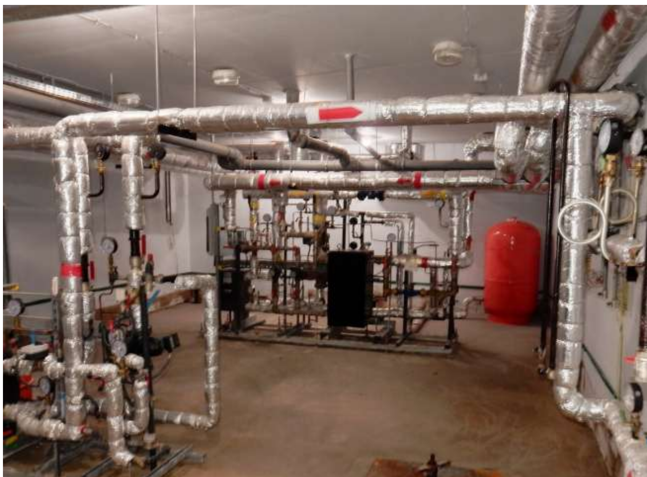
Наши тепловые узлы с автоматической системой регулирования подачи тепла
