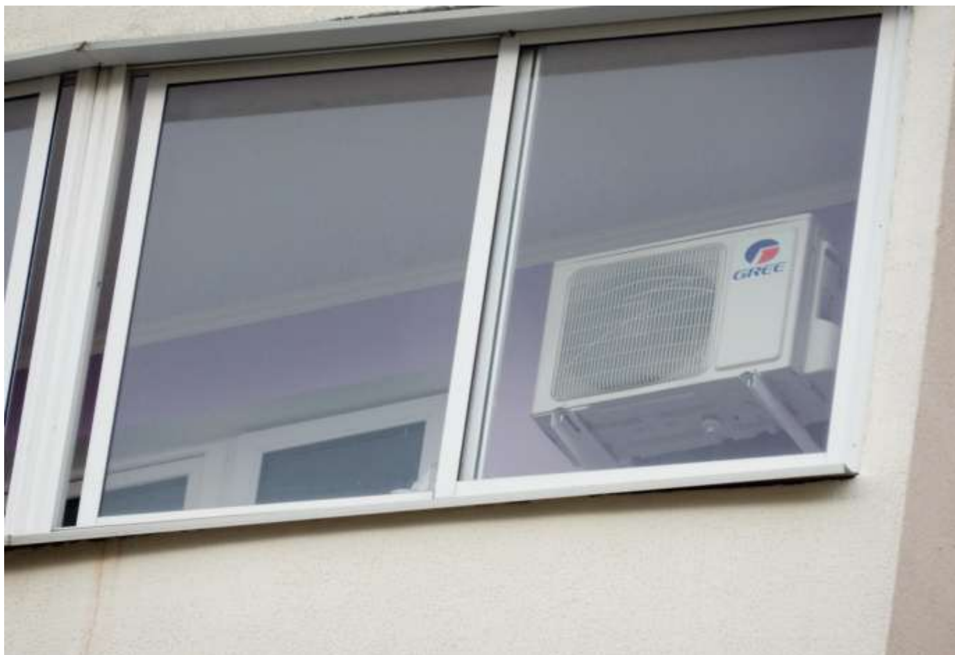
Блок кондиционера жилого помещения на лоджии
